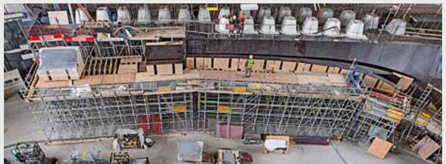
Die Anwendung auf der Baustelle erfolgte ähnlich einer Systemschalung – unterstützt durch montagegerechte Einsatzpläne.
