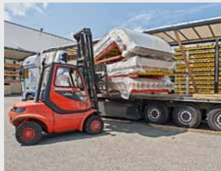
Die passend konfektionierten Maßelemente wurden entsprechend dem Bauablauf just-in-time und in maximaler Qualität auf die Baustelle geliefert.
